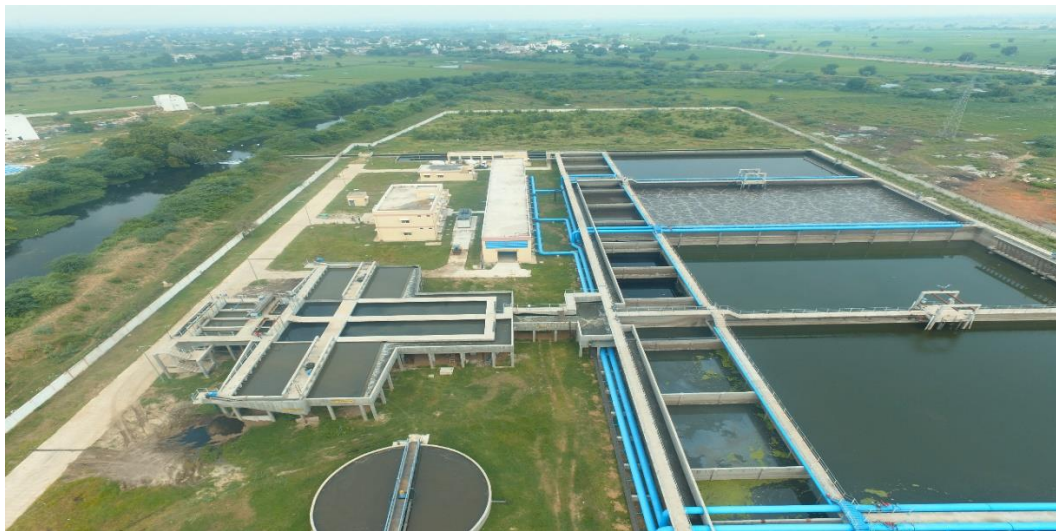
Image: 145 MLD Sewerage Treatment Plant, जलालपुर, ग्वालियर
